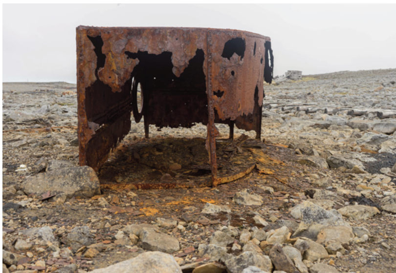
Fig. 2: Flere større jernobjekter i området rustet opp i stor fart på grunn av den salte luften som blåser inn fra havet.
